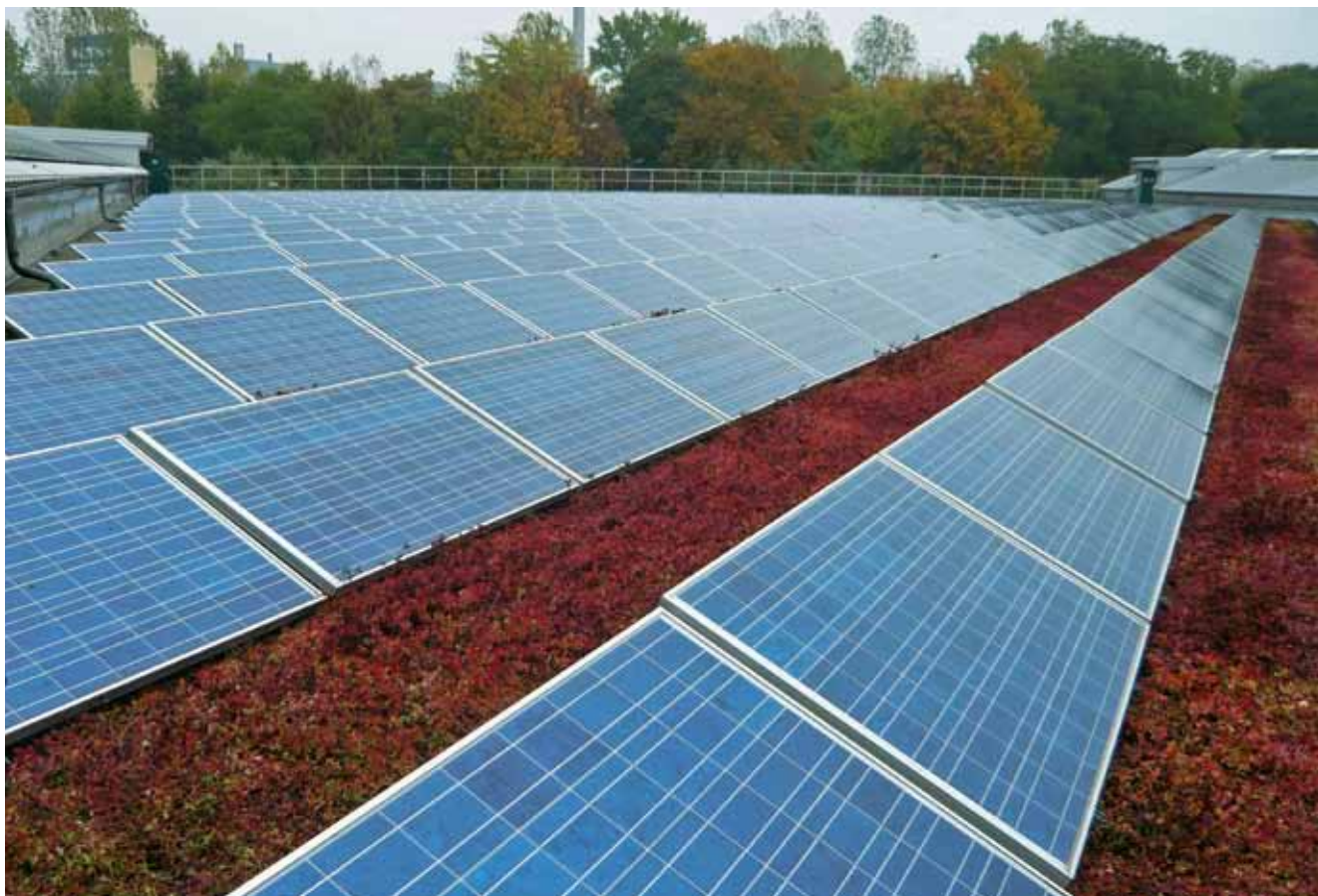
Photovoltaik Stadtentwässerung Dresden, Foto: Stadtplanungsamt Dresden
